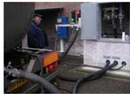
Das automatisierte Entladungssystem von Orbit Logistics, Leverkusen, erkennt mit Hilfe von RFID, welches Produkt angeliefert wird, prüft die Tanks auf ihr Volumen und weist dem Lieferfahrer den richtigen Tank zu.
