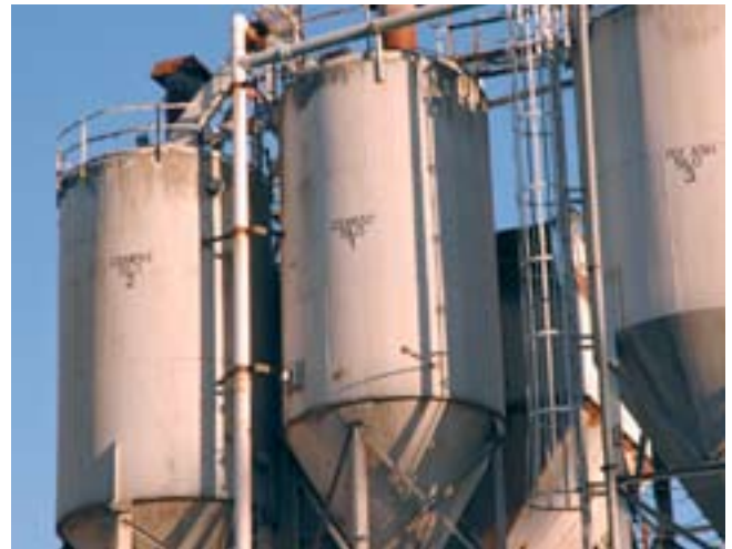
4 Level measurement on a silo • Füllstandsmessungen am Silo
